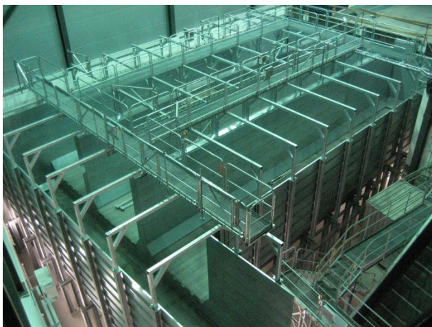
Spirofloor® bunkers voor afvalsortering te Oslo, Noorwegen. (ca. 1000m3)
